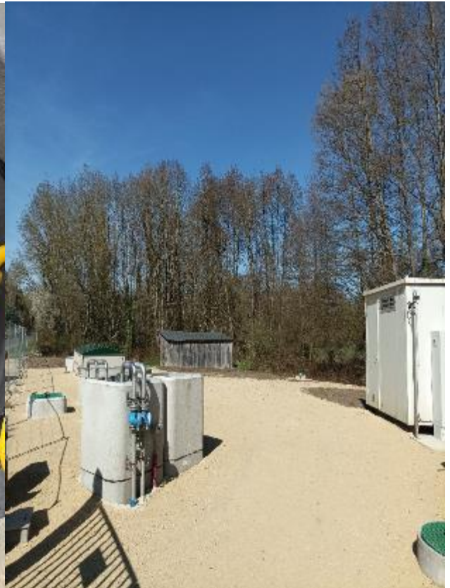
Station d'épuration de Loché-sur-Indrois
